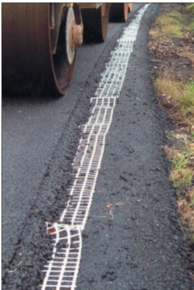
Fot. 2. A. Siatka z włókien szklanych krajowej produkcji zabudowana w 2004 r. na jednej z dróg krajowych w ramach kontraktu „REH”. Widoczny stopień destrukcji już nawet poza warstwami MMA. Widoczna również bliska zeru szczepność z warstwami MMA.
