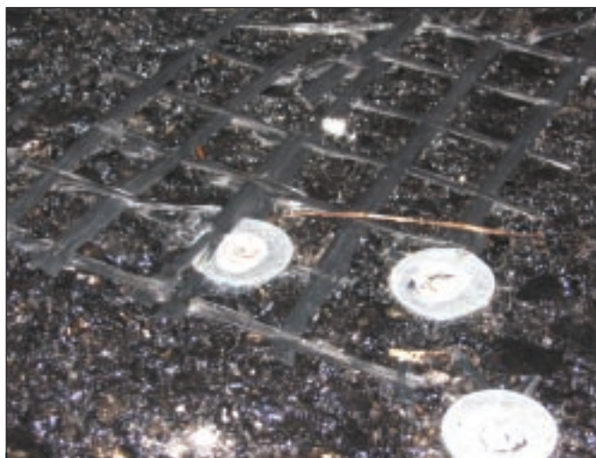
Fot. 3. A. Zamieszczana między warstwami nowej nawierzchni bitumicznej fabrycznie powleczona bitumem SIATKA SZKLANA układana na DK-1 (fotografia z XII. 2004r.). Widoczne uszkodzenia i zerwania pasm siatki powstałe jeszcze przed naniesieniem wierzchniej warstwy MMA.
