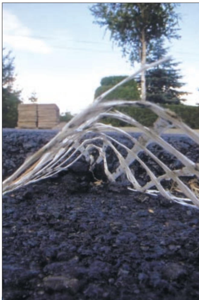
Fot. 2. B. Trudno uwierzyć, aby ten wyrób był w stanie poprawić jakość polskich dróg. Widoczne gołym okiem uszkodzenia ciągłości włókien i pasm spowodowane bliską zeru wytrzymałością na zginanie i ścinanie włókien szklanych.
