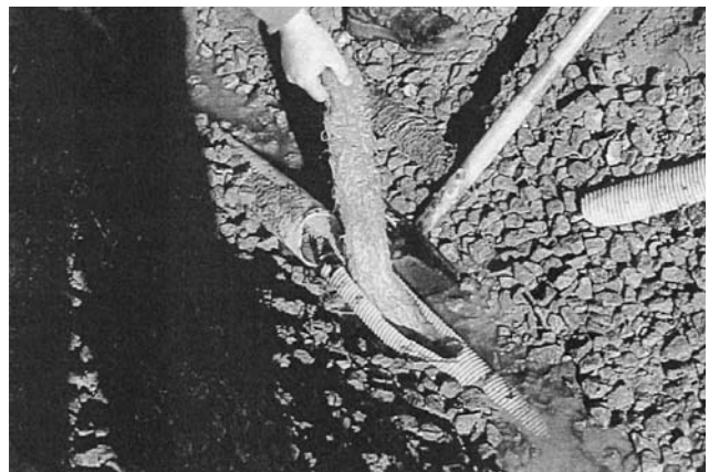
Fot. 1, 2. Dren rurowy zatkany korzeniami roślin
