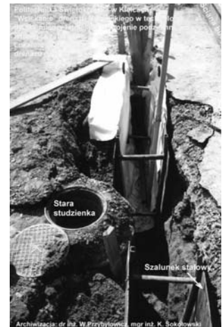
Fot. 9. Głęboki (5 m), pionowy D.F. zabezpieczający budynek Politechniki Świętokrzyskiej w Kielcach; rozwiązanie INORY
